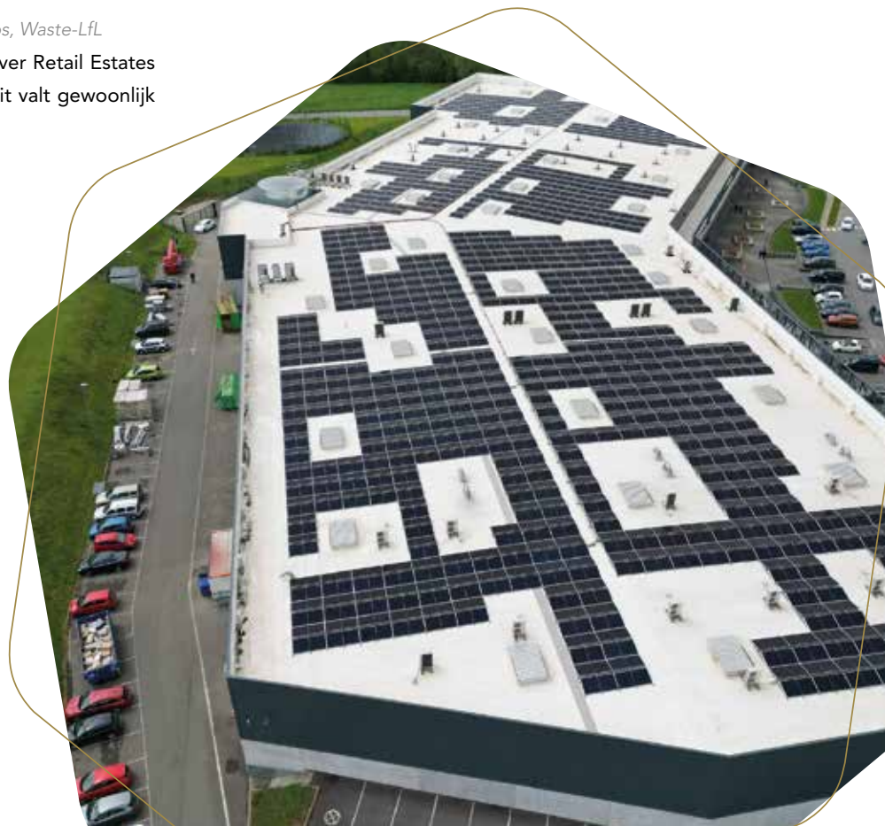
Zonnepanelen op het dak van het retailpark in Aarlen
